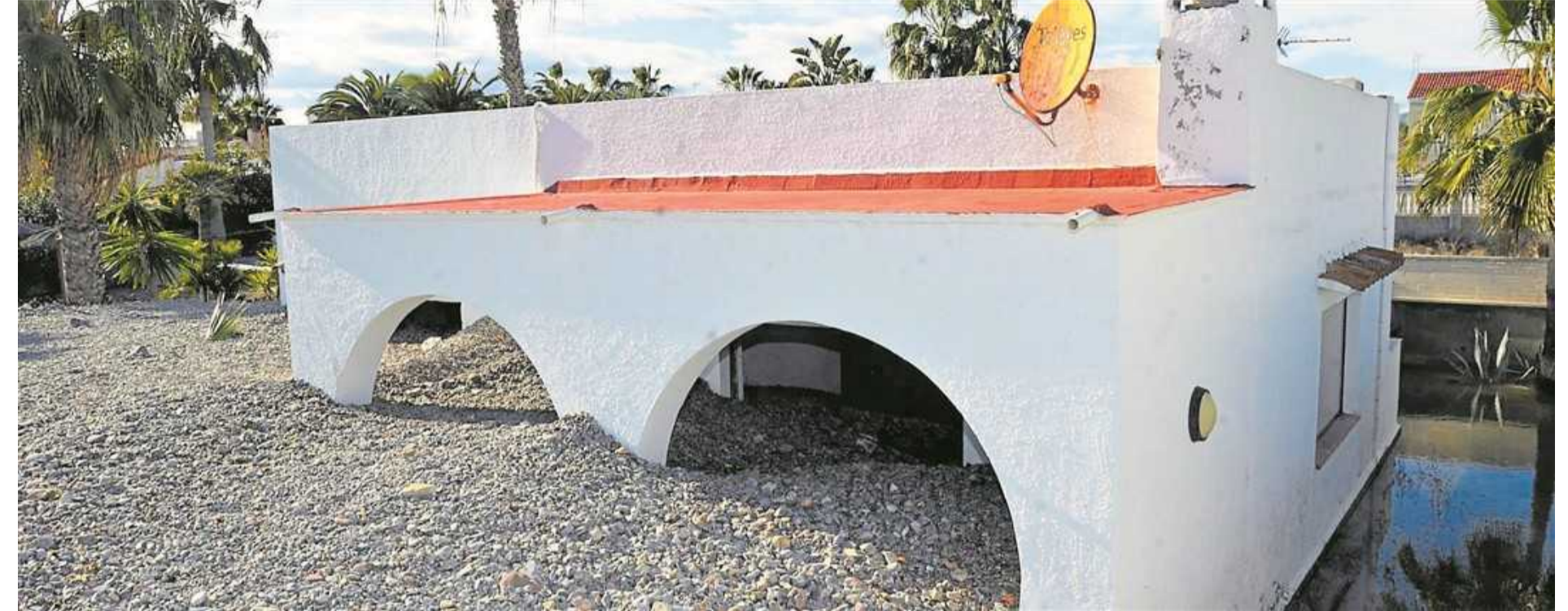
Una vivienda, en primera línea de playa en la urbanización La Torre-Camí Cabres, que quedó totalmente sepultada por piedras y tierra movidas por el temporal marítimo.
