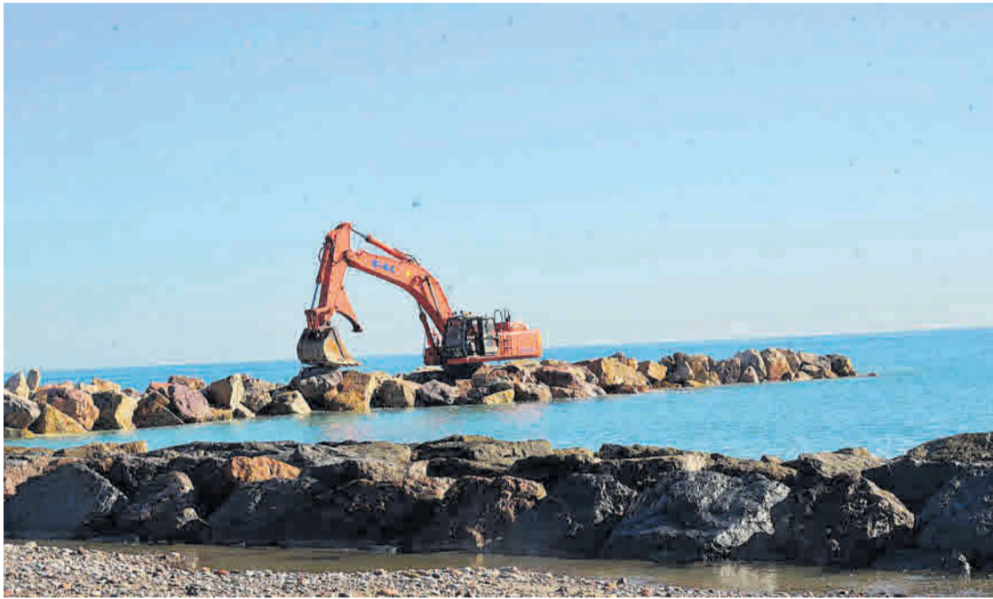
La maquinaria pesada especializada lleva a cabo la construcción del espigón existente en la zona del Camí Cabres.
