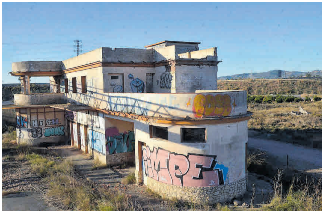
Este es el estado de abandono en que se encuentra actualmente el edificio de la antigua estación de Moncofa.
