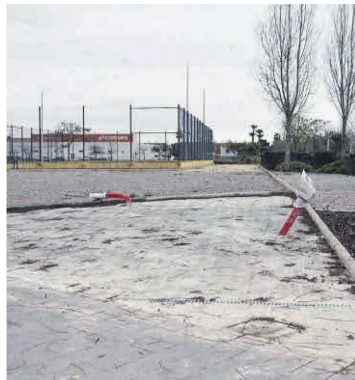
Espacio en el que se ubicará la recarga de vehículos y bicicletas eléctricas.
