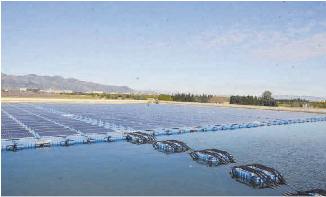
Sobre la balsa de riego por goteo se han colocado las 840 placas solares que reducirán el coste del consumo eléctrico.
