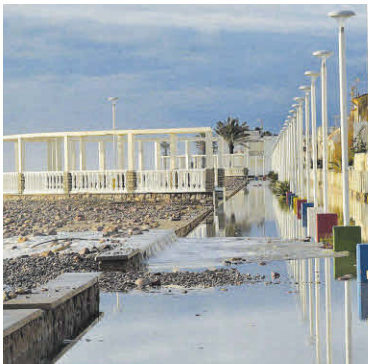
El paseo marítimo lleva muchos años sufriendo la entrada de agua del mar.
