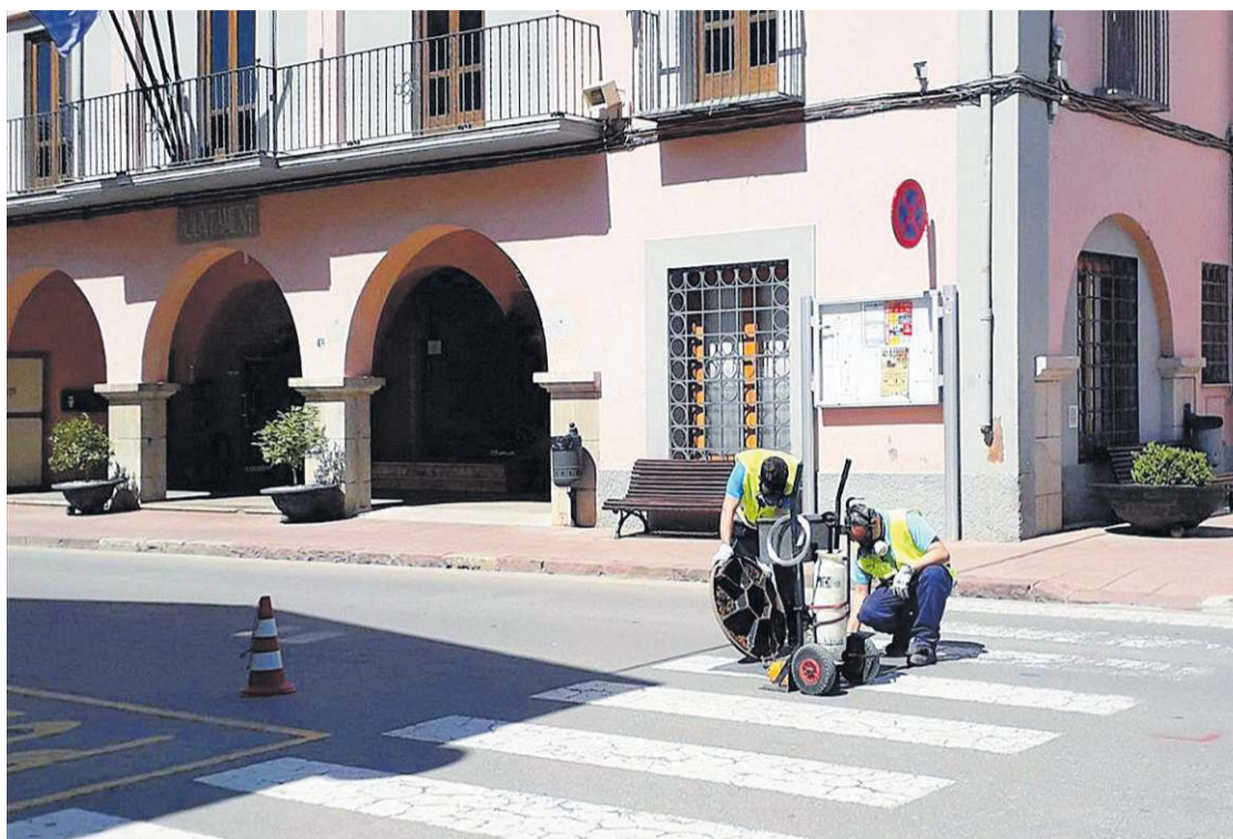
Operaris de l'empresa Facsa comprovant l'estat de la xarxa de clavegueram, en la zona centre del casc urbà.
