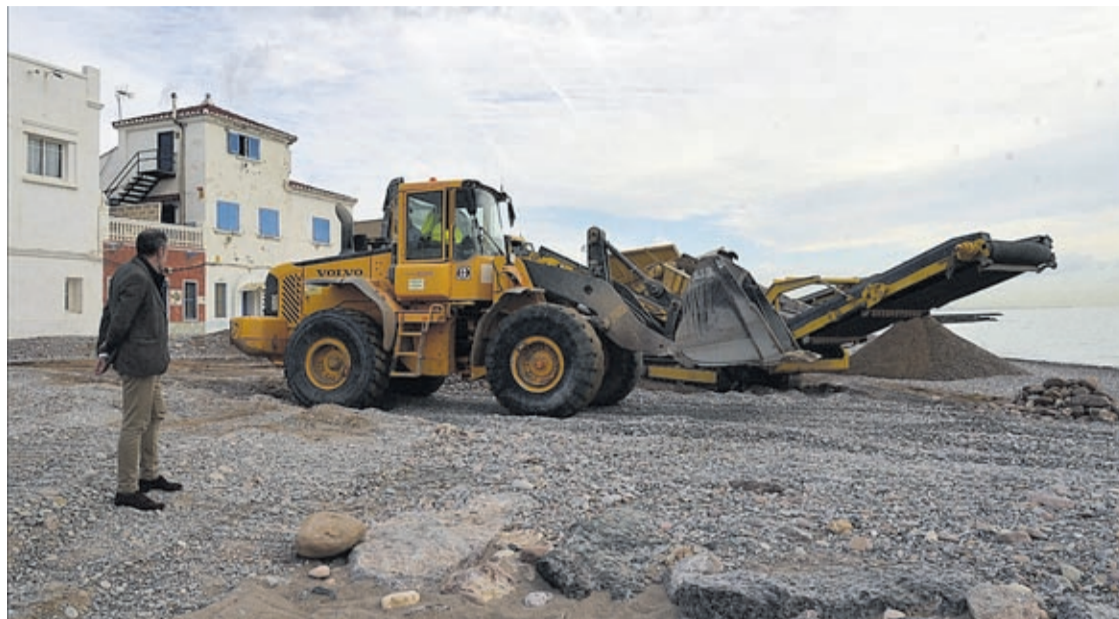
La maquinaria pesada trabaja a marchas forzadas para dejar en las mejores condiciones la totalidad del litoral.
