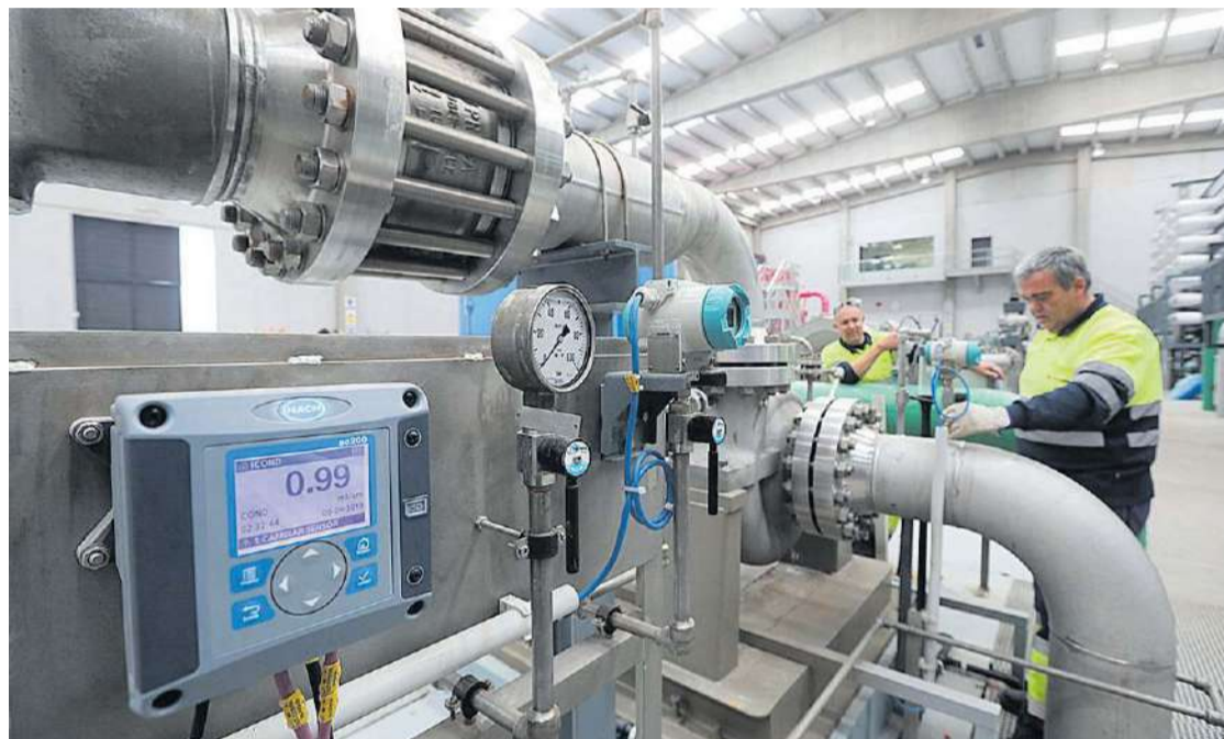
La planta desaladora entró en funcionamiento el 27 de marzo y ya está alimentando la red pública con agua desalada.
