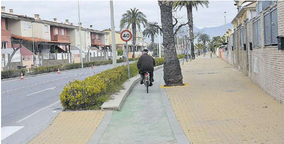
Estado en que se encuentra actualmente el carril bici de l'avinguda Científic Avel·lí Corma que necesita una mejora.
